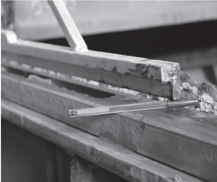
Figura 4. Desnivelamento das vigas de apoio das réguas de selagem da máquina de sínter com inserção de cerâmica.
